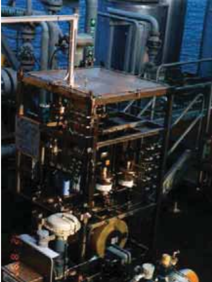
Bild 3 Elektrolyseur auf der Offshore-Plattform „Ram Powell“
