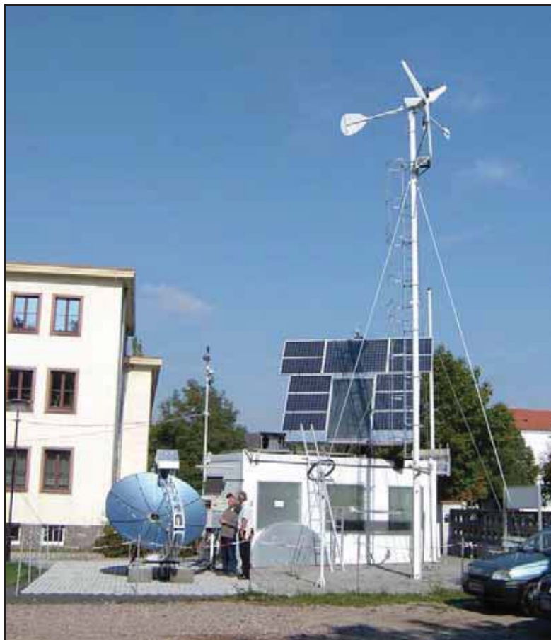
Bild 1 Komplexversuchsstand „Regenerative Energien“
