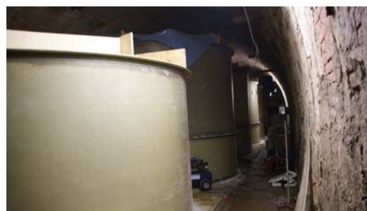
Abb. 04 Einbau der insgesamt 6 GFK-Wärmespeicher in einem Teil der ehemaligen Kellergewölbe der Brauerei (Quelle: Foto J. Bühl Ilmenau 08/2008)
