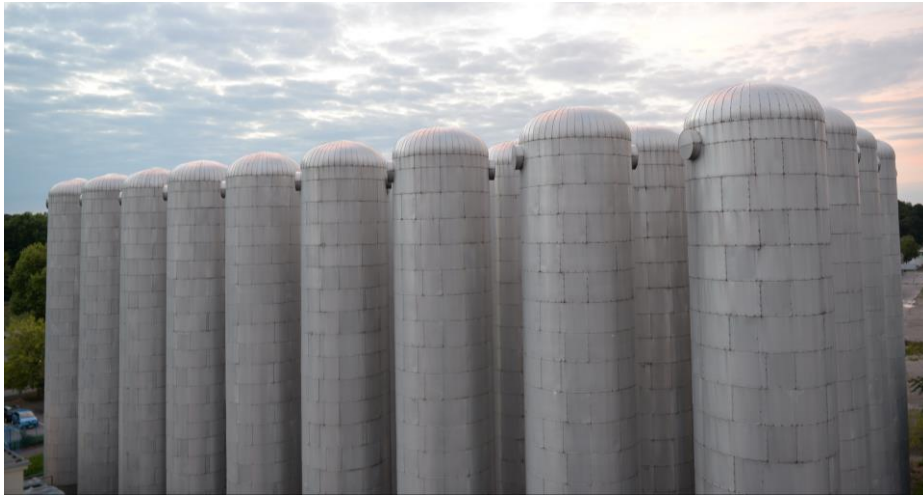
Abbildung 2: schlanke Heißwasserspeicher, vier mal neun Speicher in Reihe, Fernwärmeversorgung Chemnitz, Betreiber eins/inetz,
