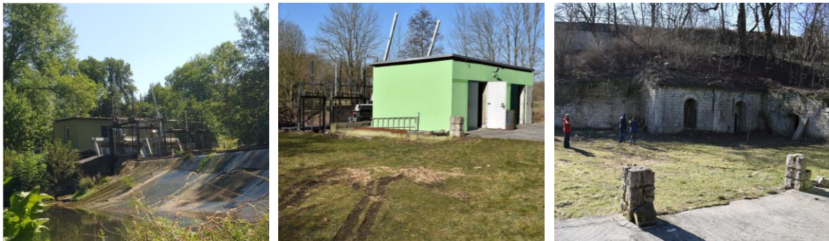
Abbildung 1-3: Wehr (links), Turbinenhaus (Mitte), Grundstück mit Kellergebäuden (rechts) an der Kleinwasserkraftanlage Oberroßla
