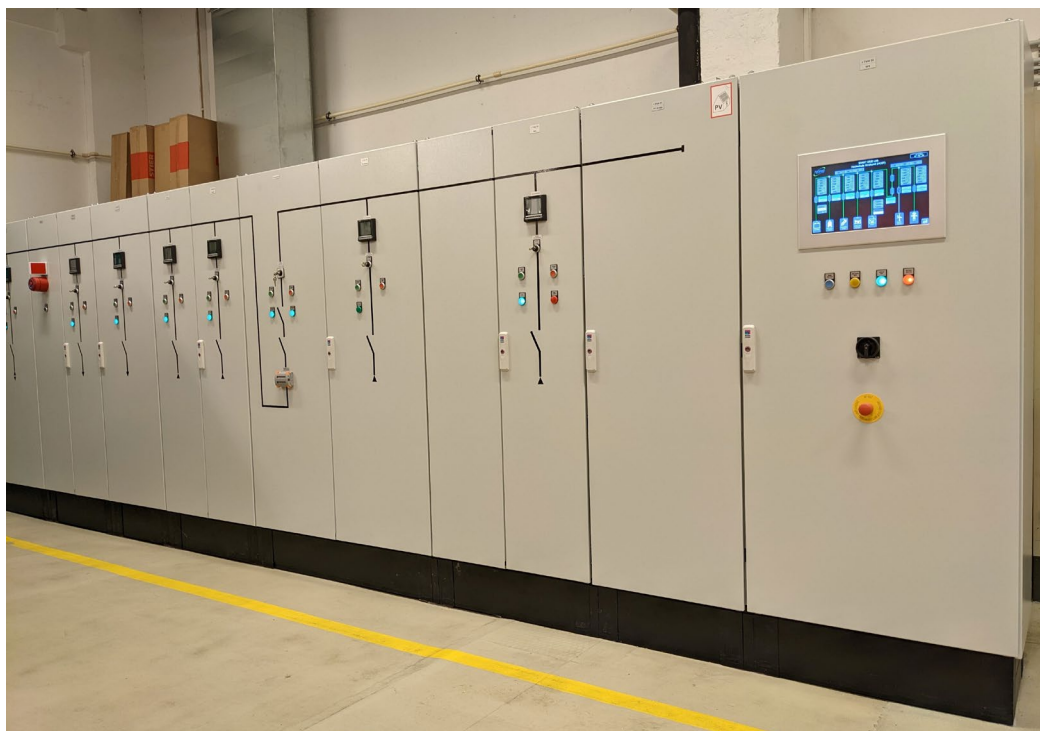
Abbildung 2: Schaltanlage des SmartGridLab
