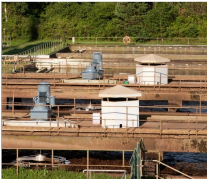
Abbildung 2: Becken mit Belüftungskreisel
