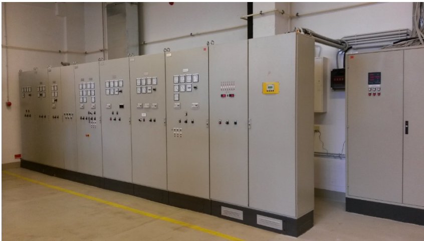
Abbildung 1: Aktuell vorhandene Schaltanlage
