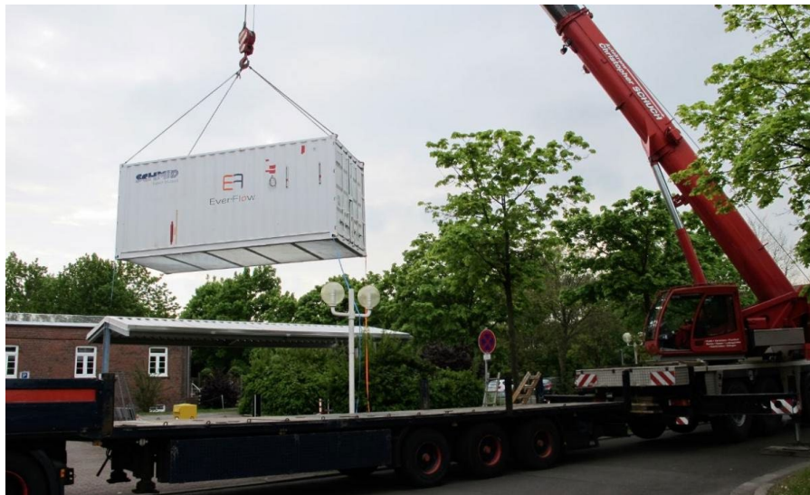
Abbildung 1: Lieferung und Aufstellung des Batteriecontainers (Bildquelle: IZES gGmbH)
